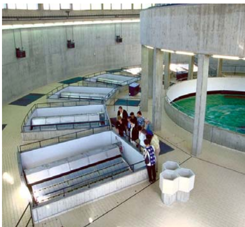
Wasseraufbereitungsanlage Sipplinger Berg; links Mikrosiebe, rechts das Quellbecken
